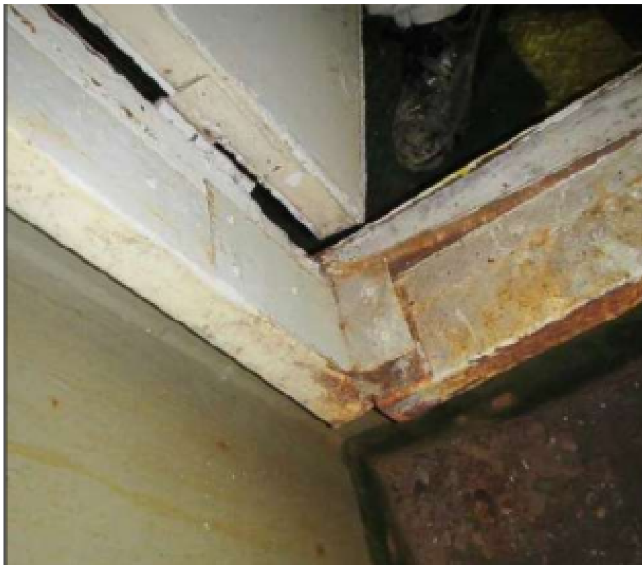
Broken fire door frame
